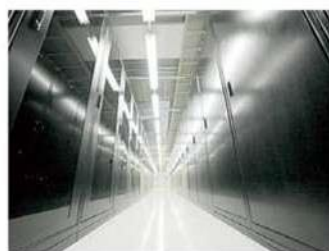
データが保管されるサーバーーム
